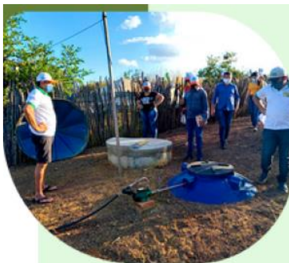
Figura 3 - Unidade demonstrativa de reuso de águas cinzas e consórcio vegetal
